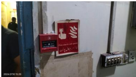
Fire alarm point.jpeg
